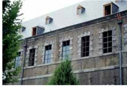
106. Pose des nouveaux châssis transposant le graphisme du châssis primitif, visible ici à l'extrême droite.
