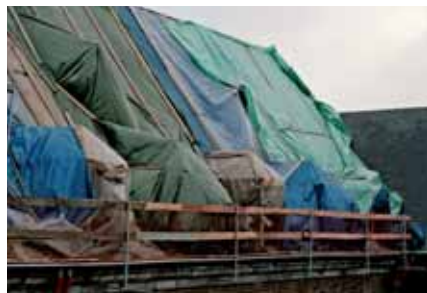
104. Versant de toiture et lucarnes en attente de l'ardoisier, ou Saint-Gilles emballé par Christo!
