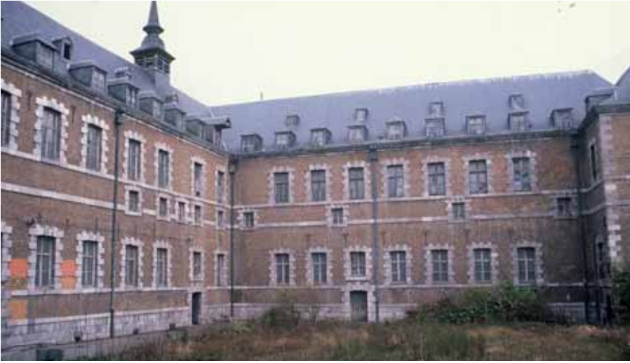
2. Après 25 ans d'abandon, l'état de l'hospice Saint-Gilles avant la restauration des années 1990 : broussailles dans la cour, vitres cassées, délabrement des toitures et des maçonneries.
