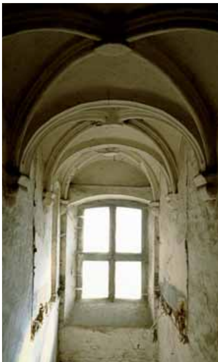
69. Les voûtes de l'escalier de la chapelle, avant restauration. Les croisées d'ogive, en tuffeau de Maastricht, ont été reconstruites « à l'identique » en 1696, après le siège anglo-hollandais de 1695. Tradition gothique et influence baroque se mêlent curieusement dans les modénatures.
