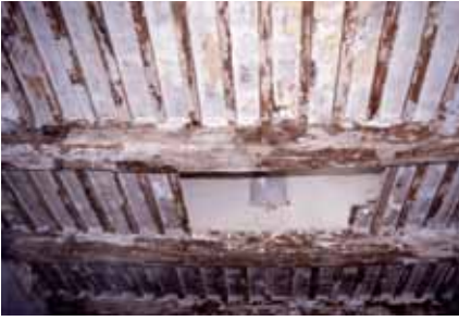
81. Intéressant plafond dans l'aile du XVIII e siècle, témoin d'une transition entre les modes de construire, entre tradition et modernité. Les caissons entre les solives sont couverts d'un léger enduit peint.
