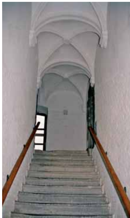
112. Le bel escalier de la chapelle, restauré. La base des murs a été simplement peinte, tandis que le haut a reçu un enduit, suivant le traitement primitif.
