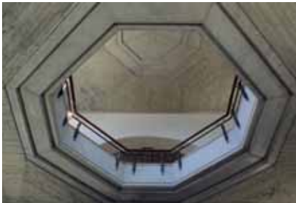
99. Percée octogonale réalisée dans l'ancienne chapelle, ménageant une échappée vers l'étage supérieur, où se dessine un octogone de béton au jeu de coffrage soigneusement dessiné.
